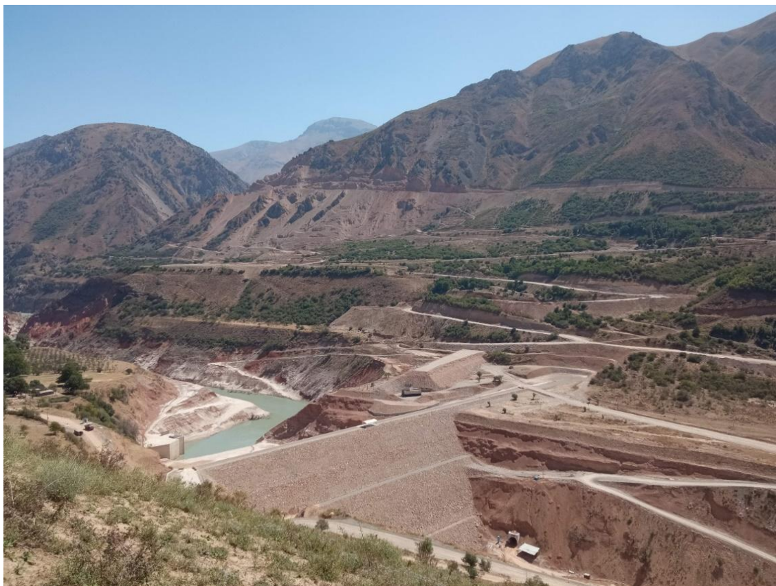
Рисунок 14. Строительство Пскемской ГЭС в долине реки Пскем, 2023 г. Источник: коалиция «Реки без границ».
